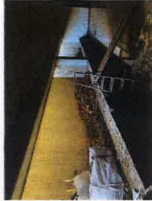
Nog te verwijderen puin en vuil kelder
